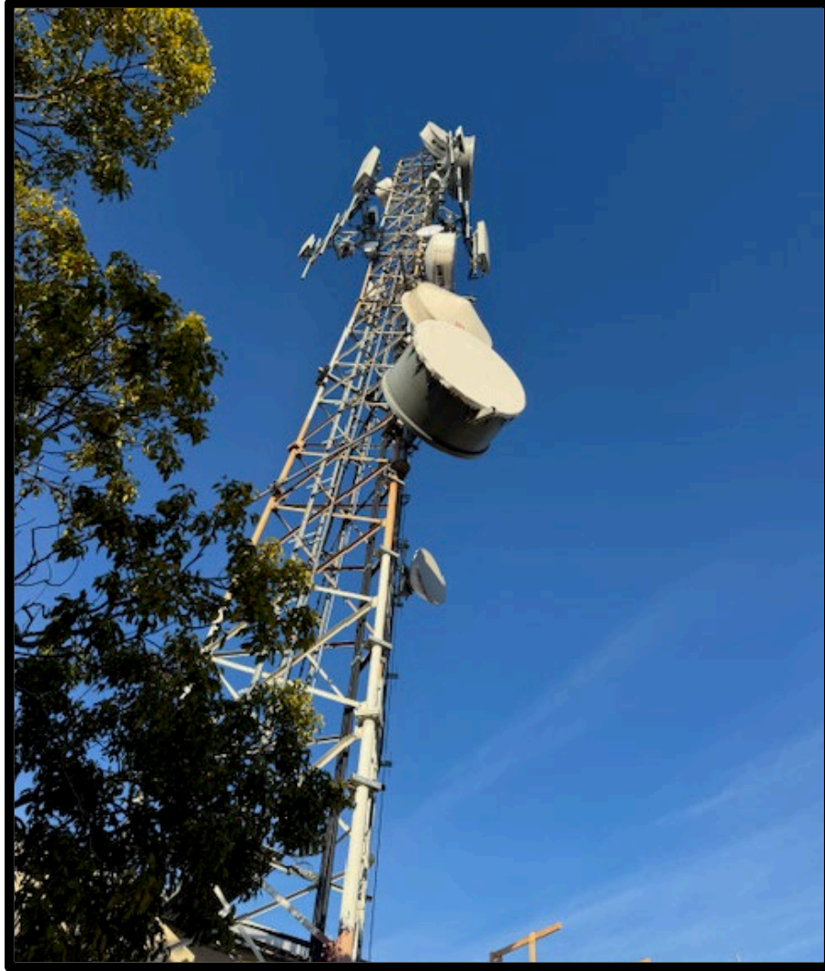
Torre en Salinas con varios dispositivos de comunicación instalados dirigidos a las distintas torres de comunicación en todo el condado de Monterey
