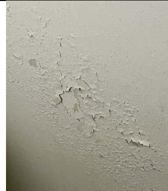
Pintura de la cocina descascarillada/desprendida
