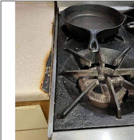
Daños en la vieja cocina/encimera
