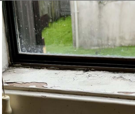
Pintura del alféizar de la ventana descascarillada
