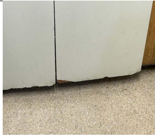
Armarios de cocina desconchados/desgastados
