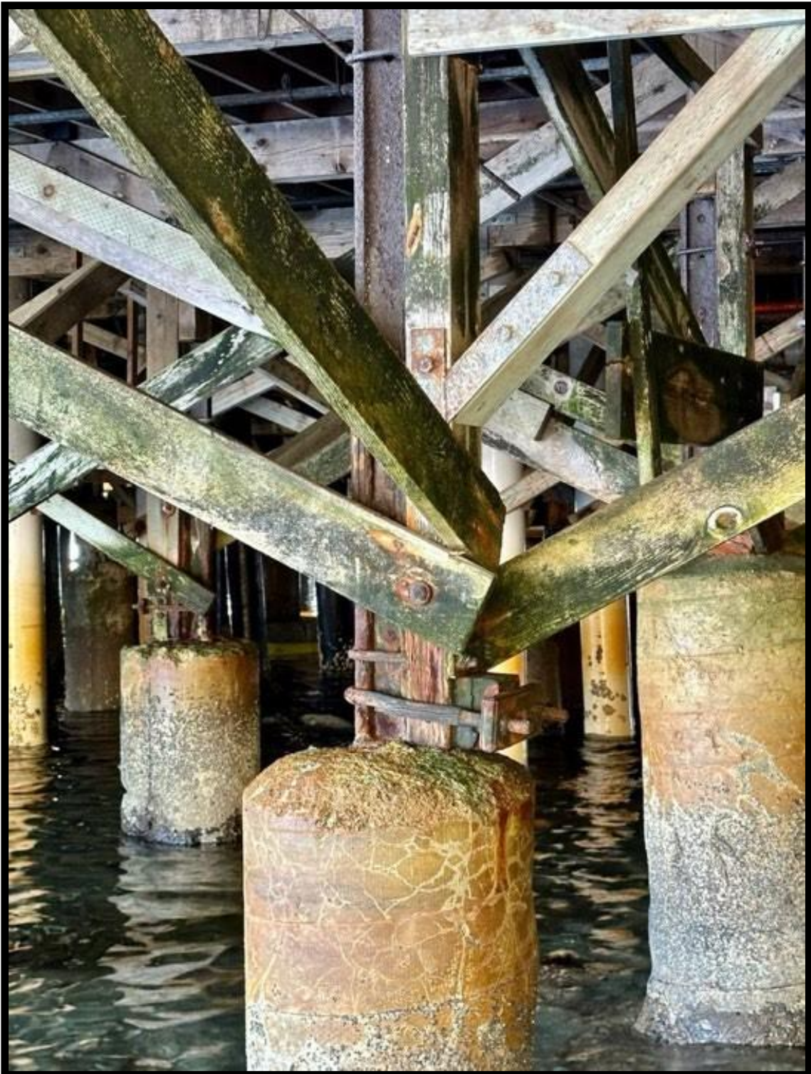
Pila bajo el muelle 1. Pilotes de acero ferroviario deteriorados unidos a pilotes de madera con pernos en U.
