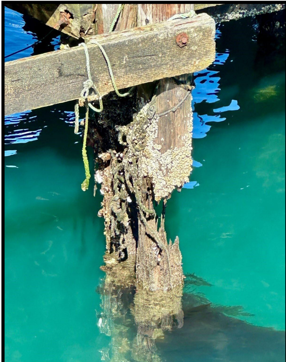
Pilotes de defensa a lo largo del muelle 1. Los pilotes de madera han perdido la mayor parte de su diámetro en la línea de flotación.
